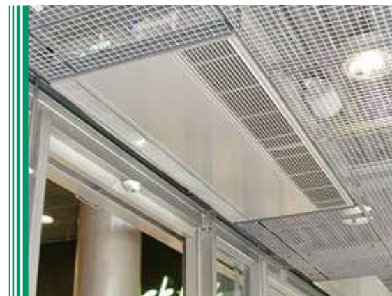
VENTILACIÓN ROOF TOP
